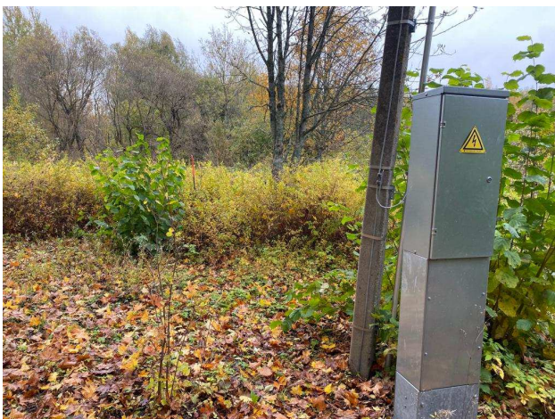
Elektrības skapis pie zemes vienības
