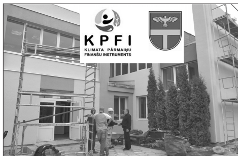
Фото И.Артемяева: Председатель думы Ливанского края Андрис Вайводс (справа) во время ремонтных работ посетил Яунсилавскую основную школу, чтобы ознакомиться с ходом работ по утеплению здания.
