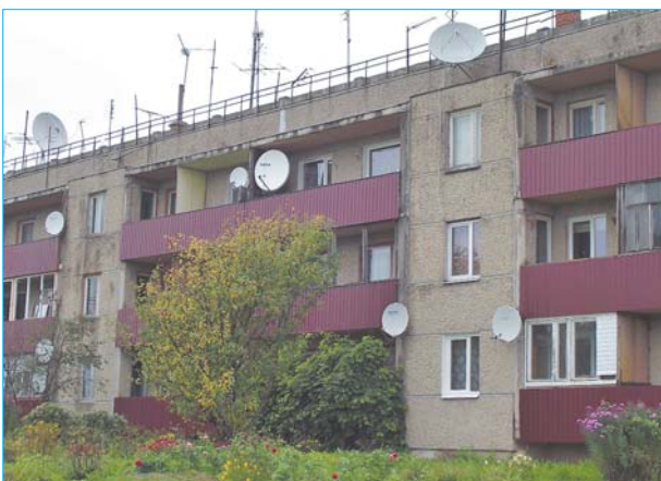
В Яунсилавас активные жители трехэтажного дома (Nr.7) в этом году написали проект и получили деньги, чтобы привести в порядок фасады балконов 27-квартирного дома. Дом построен в 1986 году. Вместо старых и прогнивших балконов теперь глаз радуется красивая отделка бордового цвета из металлического материала. Координатор Кристина Кириллова.
